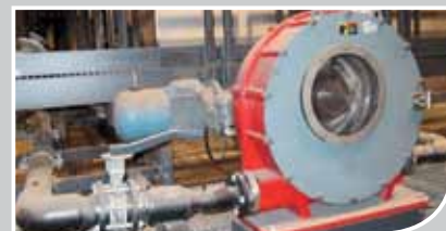
Bombas de circulación de líquido de lavado en la mina Talvivaara.
