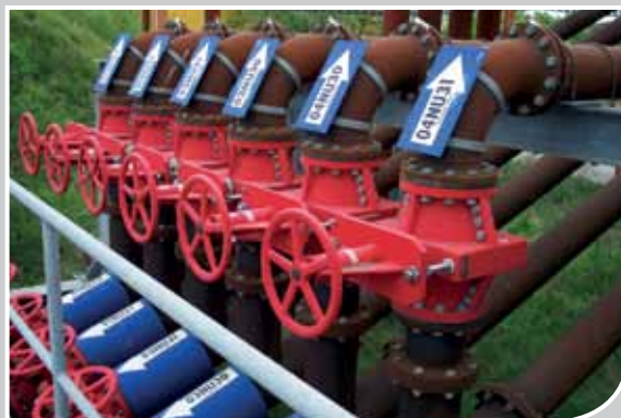
安装在DONG能源公司的枫诺管夹阀
