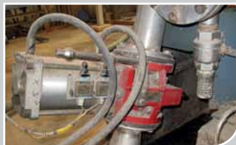
Flowrox-letkuventtiilit GIIC:n laitoksessa
